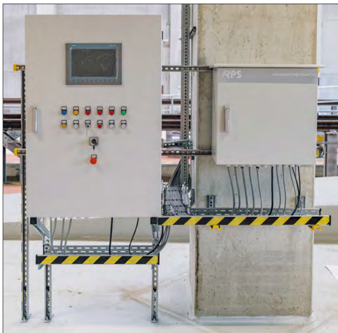
TracFeed® SAM-C und TracFeed® SAM-R zur Steuerung und Überwachung (Foto: Rail Power Systems GmbH).
